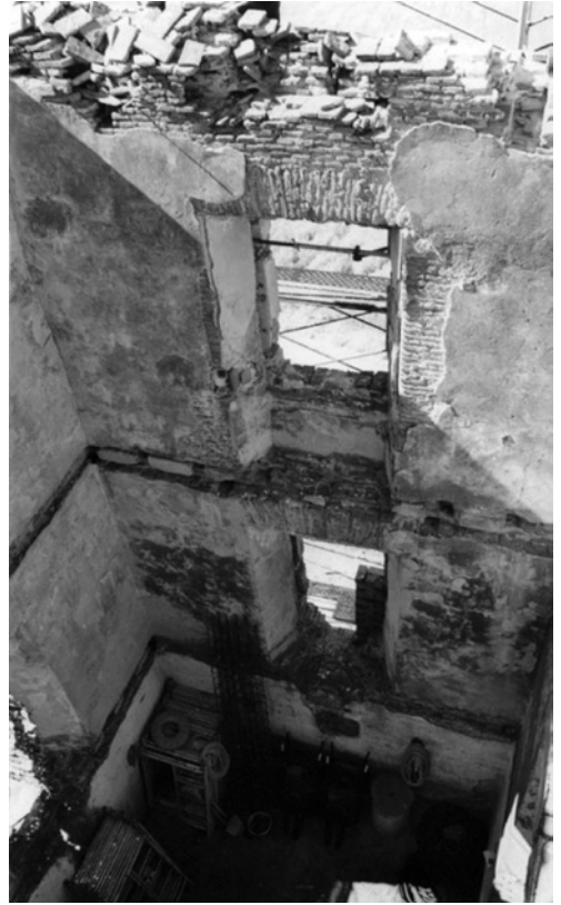
Figura 5. Estado en que se encontraba el interior de la torre de Adanero en 1999.
